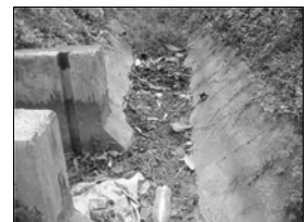
フィリピン、ボホール灌漑事業では、灌漑予定地に水が届かず、農民が借金を負う事態に発展した。写真は水がこない水路。
